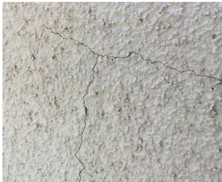
Typische putztechnische Risse verlaufen Y-förmig.
